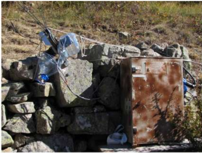
Vue générale de l'installation moteurs et boitier
